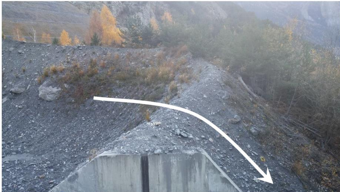
Photo 31 : Surverse massive sur une digue sans érosion significative.
