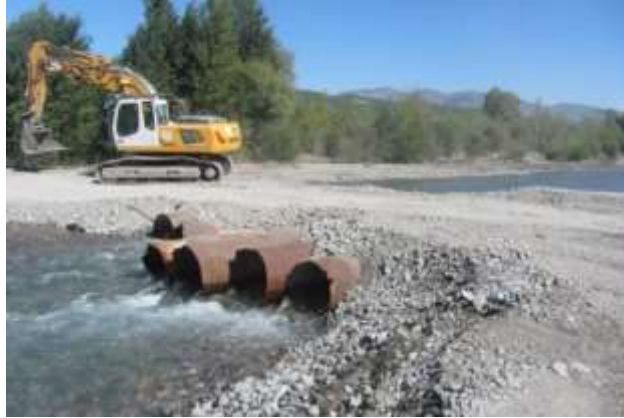
Exemple de busage temporaire mis en place sur la Bléone en 2013 sur le chantier de confortement de la digue du Gibassier au Chaffaut (SMAB)
