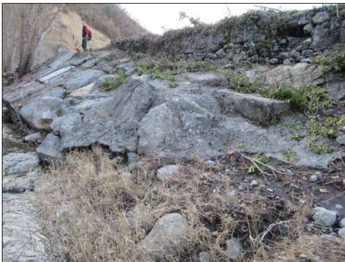
Figure 8 : Limite aval du mur (tronçon D) et limite amont de la digue de 1992 (tronçon C) – côté cours d'eau
