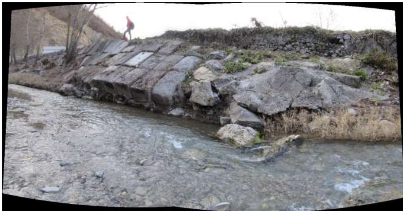
Figure 10 : Limite amont du tronçon C – secteur à fort risque d'affouillement
