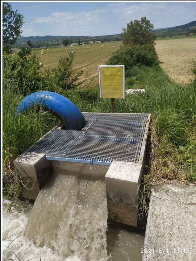
Site, avec l'ouvrage qui casse la pression
